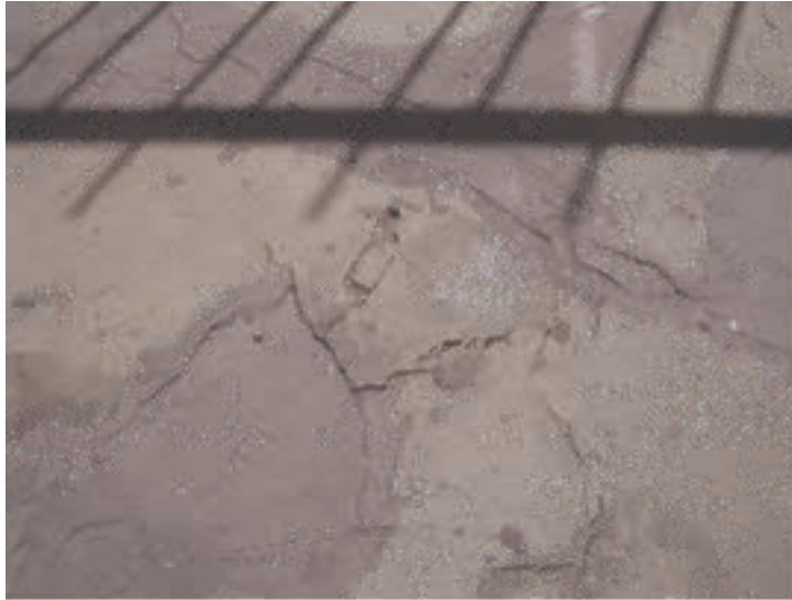
FISURAS Y DESCASCAMIENTO DEL PRODUCTO
