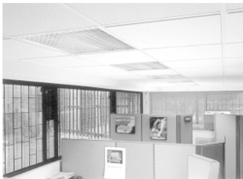
Cielo raso en fibra de vidrio
